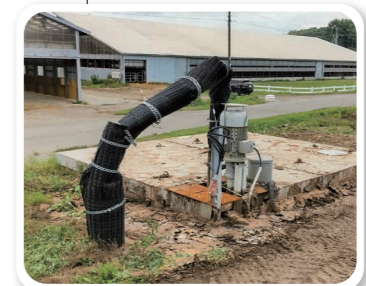
原料槽 (3日分程度貯蔵) 糞尿を一時的に貯蔵する槽です。 ・電動バーチカルポンプ
