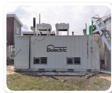
発電ユニット (20ft コンテナ) 生成したバイオガスを燃料として利用し、電力を生産する装置で、再生可能エネルギーの一環として重要です。
